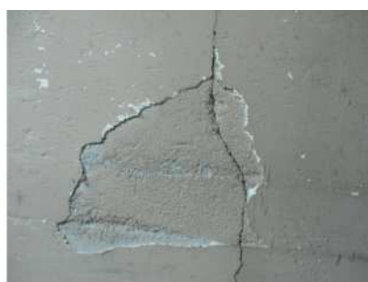
内壁ひび割れ
