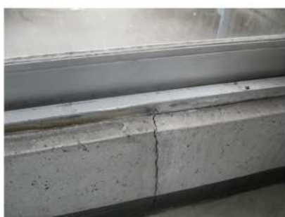
窓廻りの老朽化と 窓下のひび割れ
