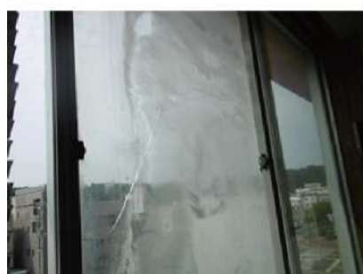
割れている窓
