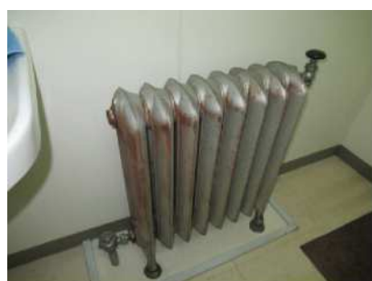
旧式の暖房設備
